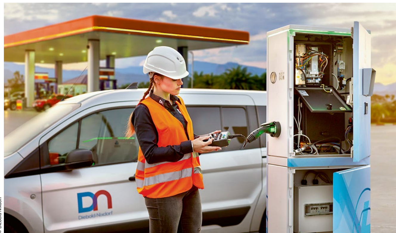
Gesamtlösungsanbieter sorgen nicht zuletzt dafür, dass die Ladesäulen reibungslos funktionieren.
